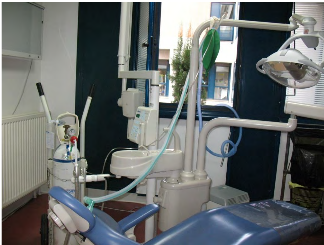
Photo 5 : Installation pour une utilisation en odontologie avec évacuation passive (tuyau par la fenêtre) [14]
